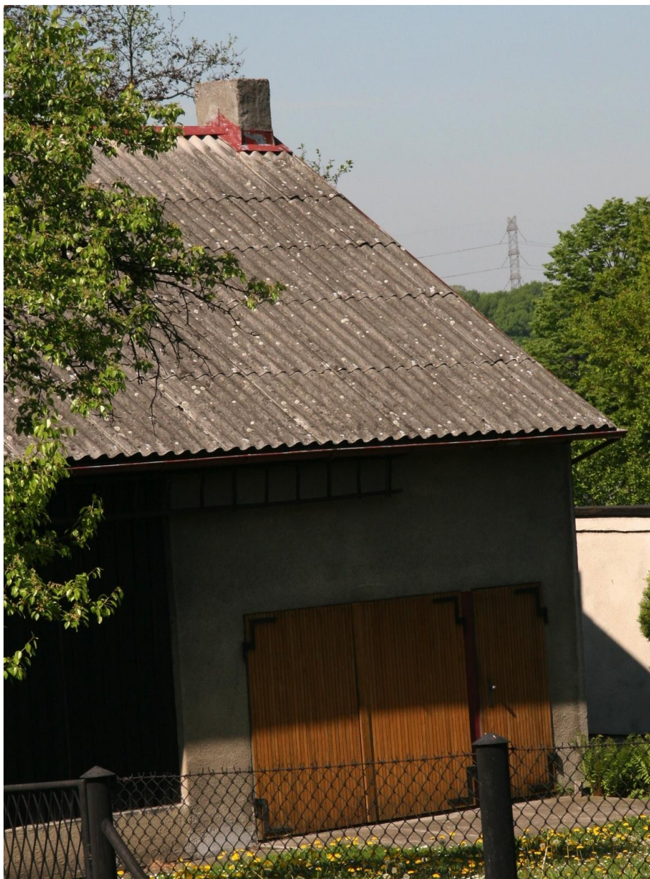
Rysunek 3 Dach pokryty płytami azbestowymi falistymi
